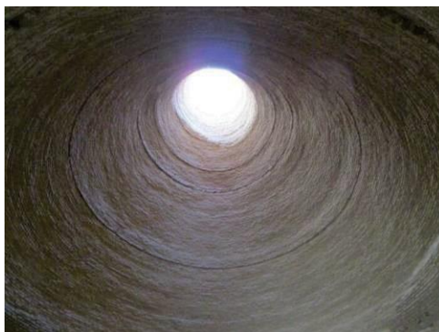
Сүрет 5 - Мұзды шұңқырдың" қабырғалары мен күмбезі арнайы ерітіндімен жабылған, ол салқындықты жақсы сақтап, ылғалға төзімді болған (яхчал, Иран). / Фото: vokrugsveta.ru.
